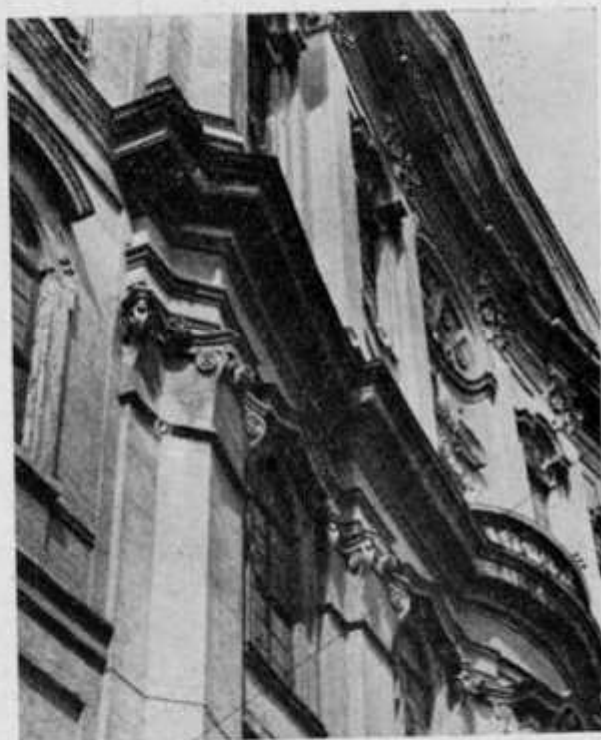
Fig. 4 - La connessione tra la facciata dell'Oratorio dei Filippini e la parete adiacente.
